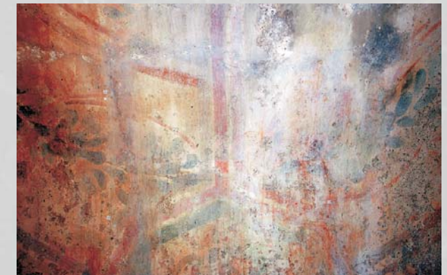
N-O-Wand, Detail der Gewölbemalerei
